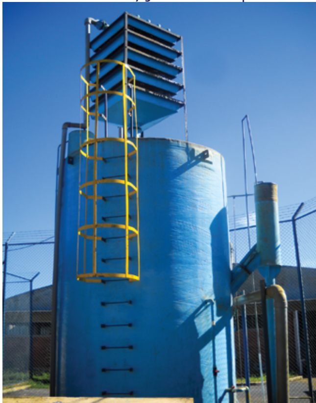
Puribloc IV con torre de 7.3 LPS Carcel de Yopal- Casanare
