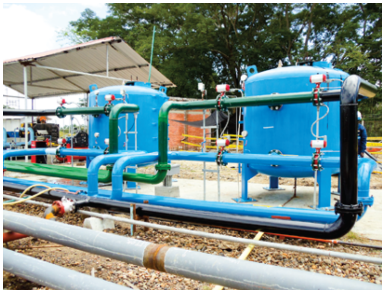
Filtros de Cascarilla de Nuez para Reinyección- 15.000 BPD, Manzarovar- Puerto Boyáca
