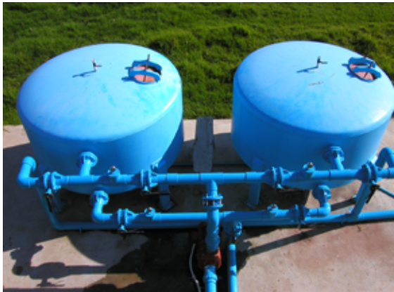
Tratamiento terciario de filtración PTAR Paipa
