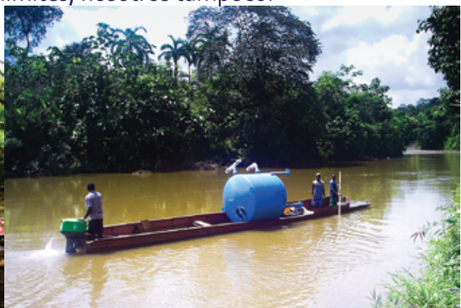
Sistema de filtración 14.5 LPS IRO - CHOCO
