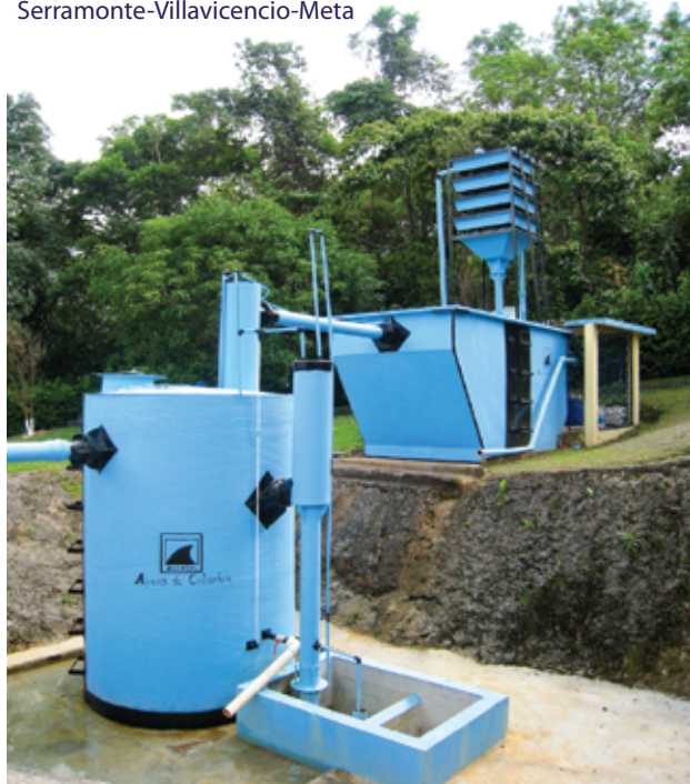
PURIBLOC II con Torre 27 m 3 /h- Urbanización Serramonte-Villavicencio-Meta
