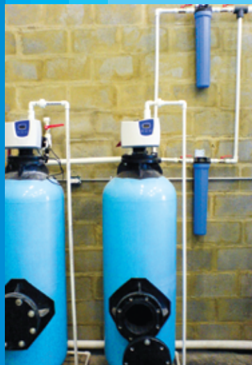
SISTEMA DE SUAVIZACION- DANONE 4.25 m3/h
